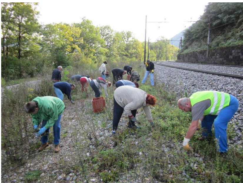
Slika 5: Urejanje brežin ob železniški progi, od koder se invazivke pogosto širijo v gozdni prostor Foto: Zala S. Božić
