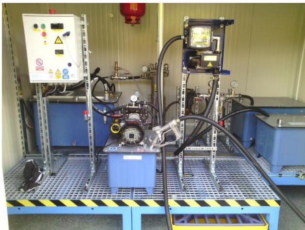
Slika 6: Mobilna enota AIS OIL CLEAN 19 za čiščenje odpadnega jedilnega olja za energetske namene (agregate za proizvodnjo zelene električne energije ter delovne stroje).
