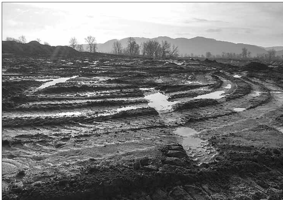
Zastajanje vode na vrhu deponij zaradi zbitosti zemljine - transport (foto: M. Šinkovec)
