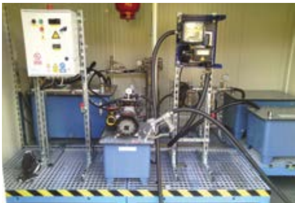
Pogled v notranjost mikro čistilne naprave AIS OIL 19 za čiščenje odpadnega jedilnega olja za pogon delovnih strojev in kogeneratorjev
